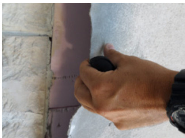
Alcuni esempi di lesioni significative su sistemi di isolamento a cappotto
