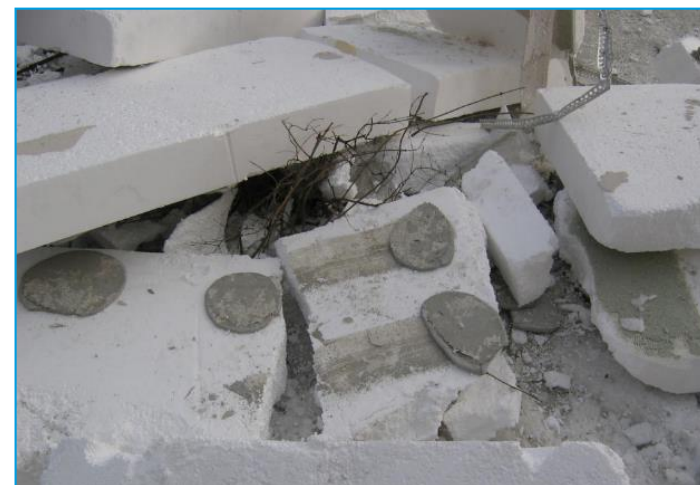
Assenza di incollaggio perimetrale
