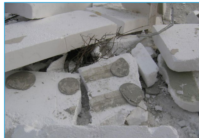
Assenza di incollaggio perimetrale
