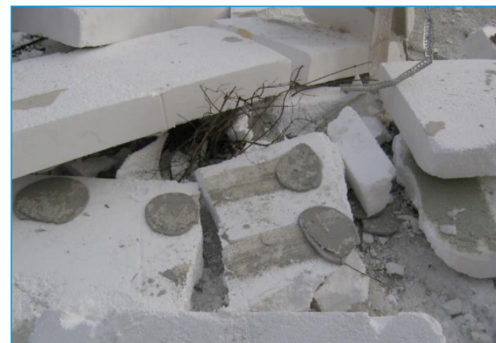
Assenza di incollaggio perimetrale
