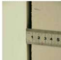
Distacco delle lastre dalla struttura lungo il perimetro
