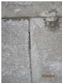
Fig. 9 Particolare sezione di prova Si notano le irregolarità (cricche) parziali.
