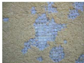
Rete mal posizionata
