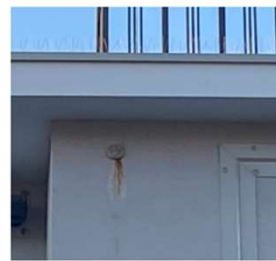
Mancato posizionamento dei nastri di guarnizione
