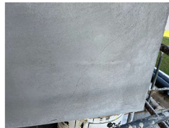
Eccessivo spessore di rasante cementizio
