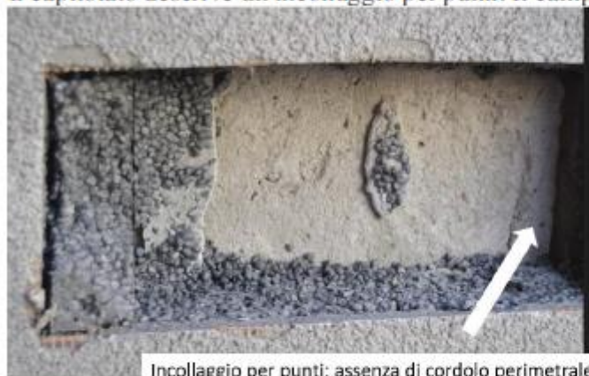
Incollaggio per punti: assenza di cordolo perimetrale
