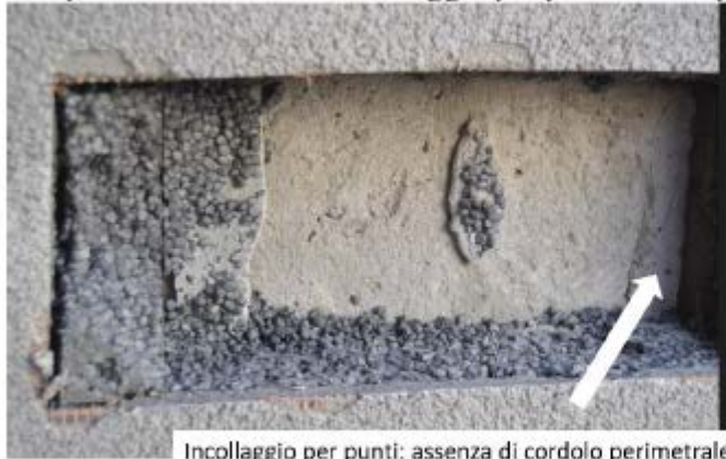
Incollaggio per punti: assenza di cordolo perimetrale
