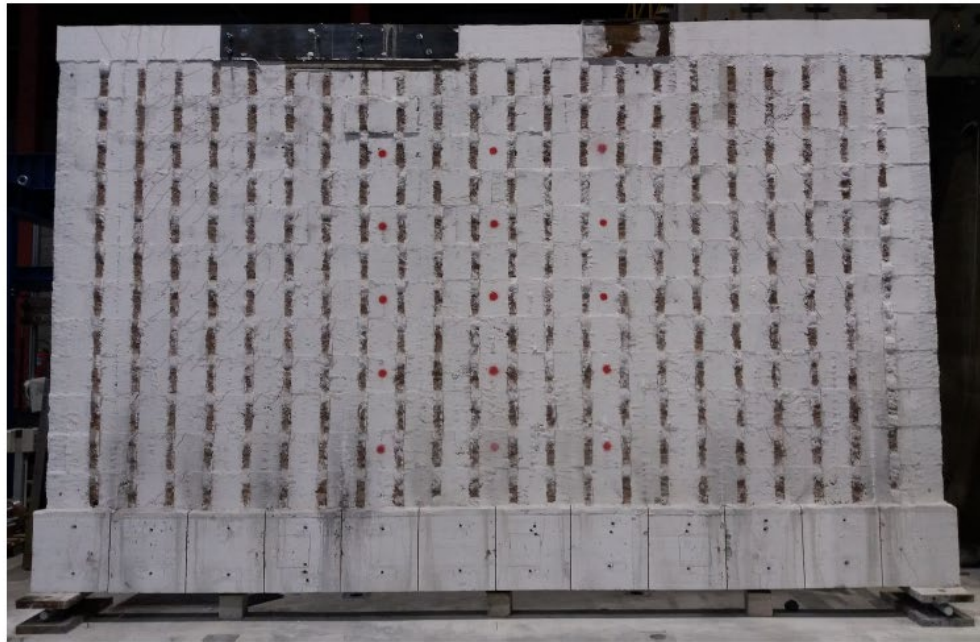
Figura 8: fessurazione diffusa inclinata di 45° della trave-parete con luce 6 m (configurazione B)
