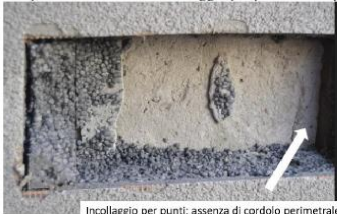
Incollaggio per punti: assenza di cordolo perimetrale
