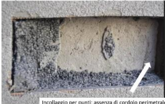
Incollaggio per punti: assenza di cordolo perimetrale
