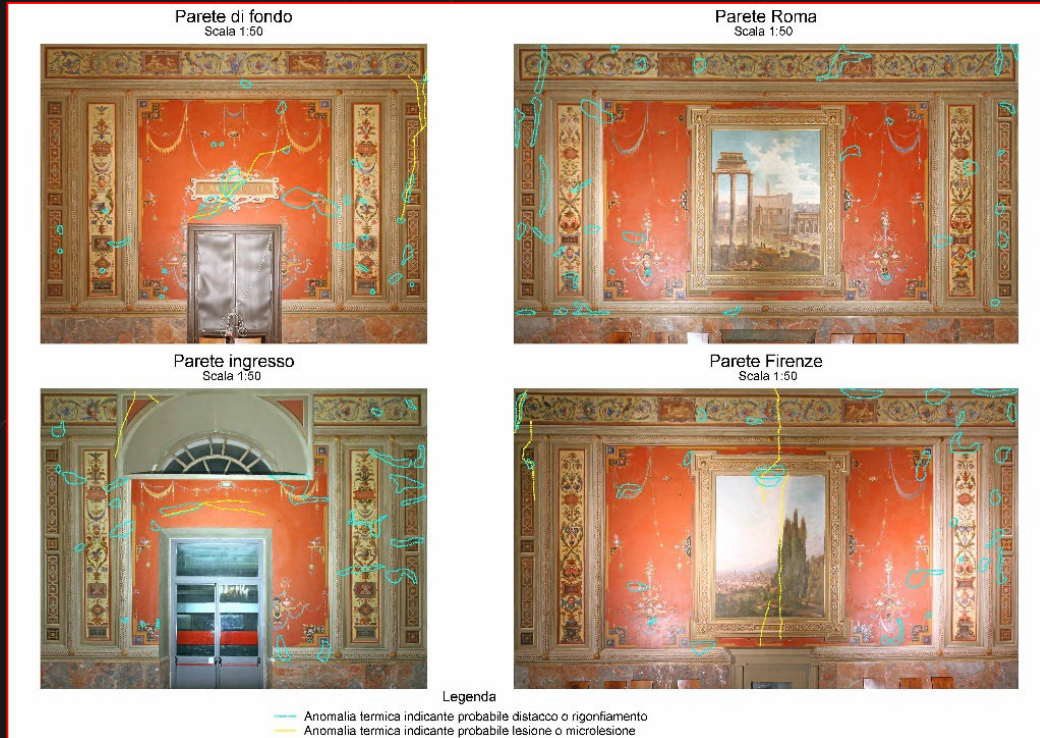
Fotopiani pareti in visibile con indicazione anomalie termiche
