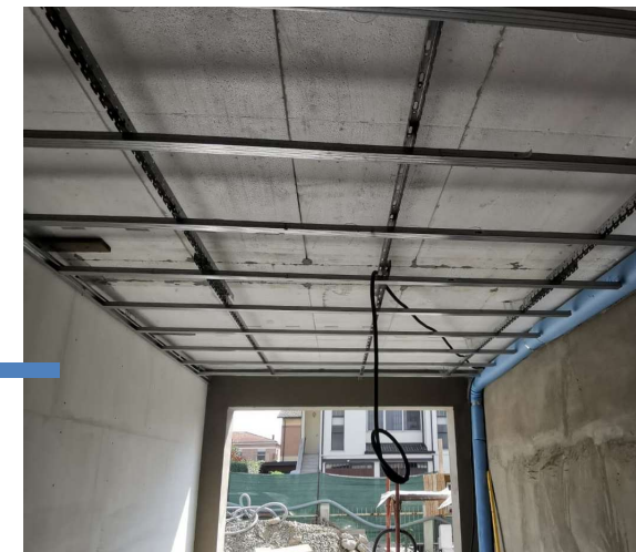
Passaggio impianti a soffitto ribassato
